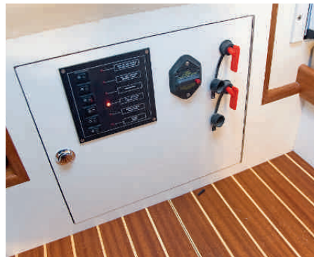
Überschaubar. Einfache, aber vollständige Bordtechnik im Niedergangsbereich
